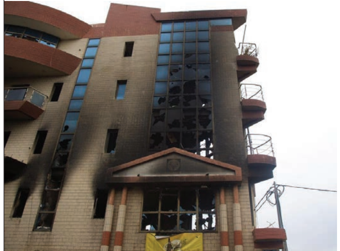
Um edifício incendiado e pilhado foi fotografado em Bamaco, Mali, no dia 19 de Agosto de 2020, na manhã seguinte do dia em que tropas rebeldes cercaram o Presidente do Mali, Ibrahim Boubacar Keita e o Primeiro-Ministro Boubou Cissé. AFP/GETTY IMAGES
